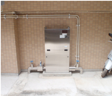
水圧不足分の用増圧ポンプ
